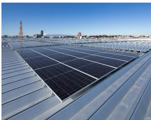
太陽光発電設備
